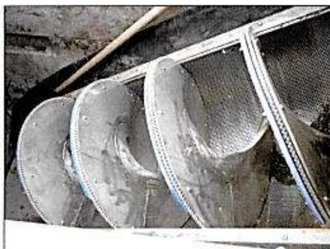
Imagem 2 - Rosca transportadora da peneira do Pré-Tratamento em inox – ETE Potecas. Fonte: Acervo Casan.
