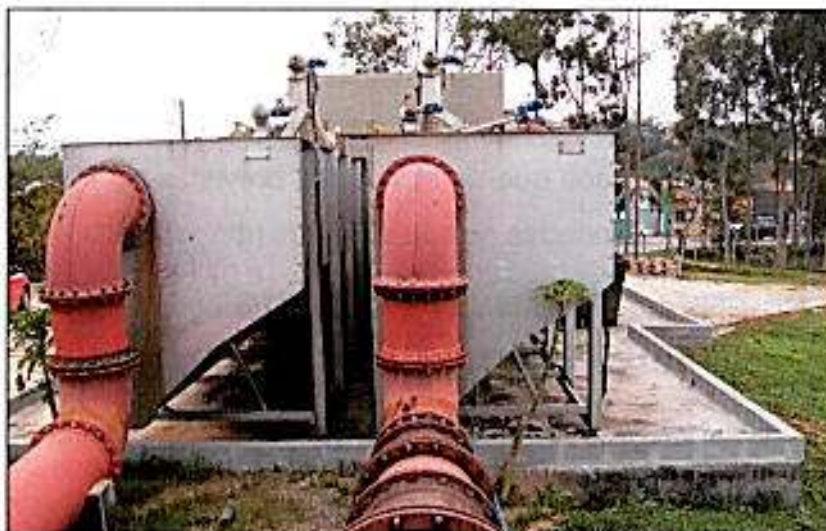
Figura 1 – Sistema de Contenção, Dreno e Acumulação de líquidos em torno do Pré-Tratamento – ETE Polecas. Fonte: Acervo Casan.
