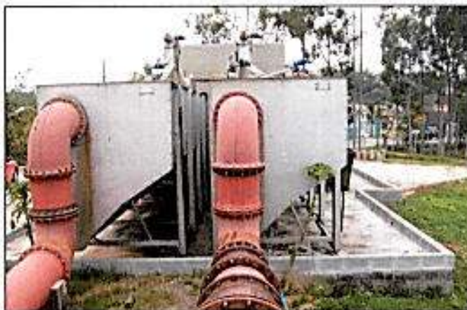
Imagem 1 - Sistema de Contenção, Dreno e Acumulação de líquidos em torno do Pré-Tratamento – ETE Potecas. Fonte: Acervo Casan.
