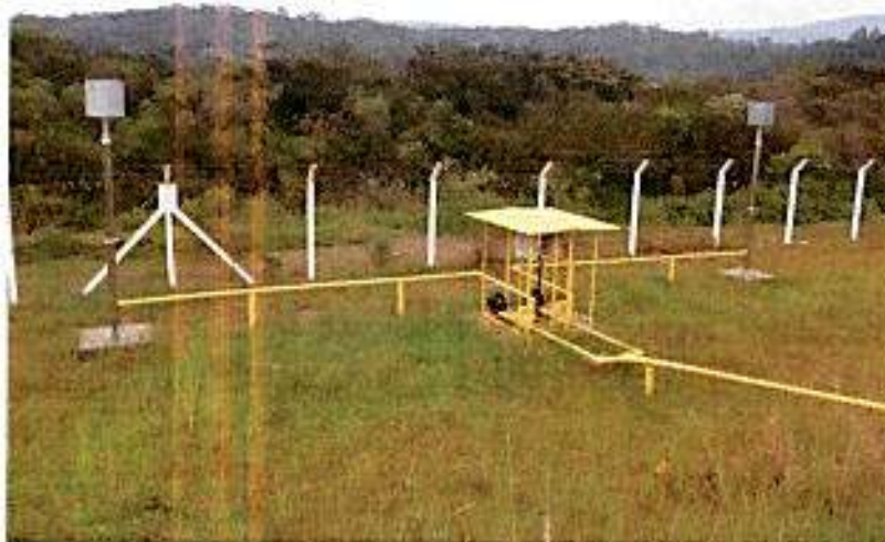
Vista de dois dos quatro queimadores instalados. Fonte: Acervo CASAN
