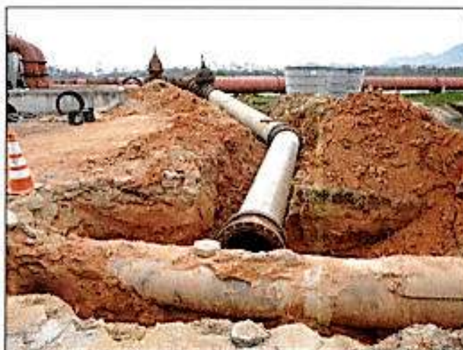
Imagem 5 - Obras para interligação do extravasor à tubulação que leva aos reatores- ETE POTECAS. Fonte: Acervo Casan
