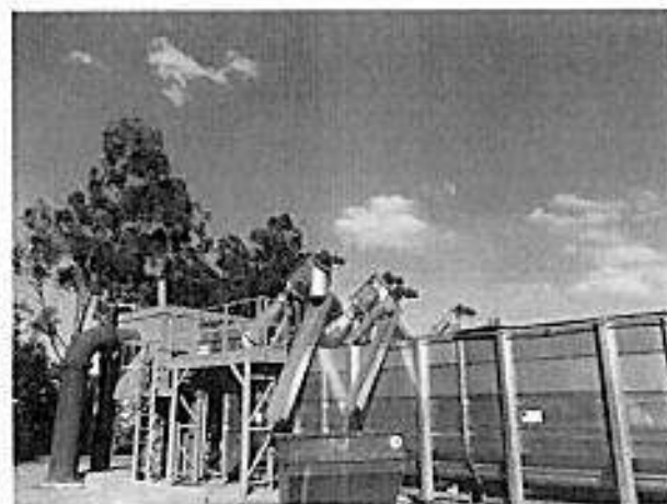
Figura 5. Tratamento preliminar por gradeamento.
