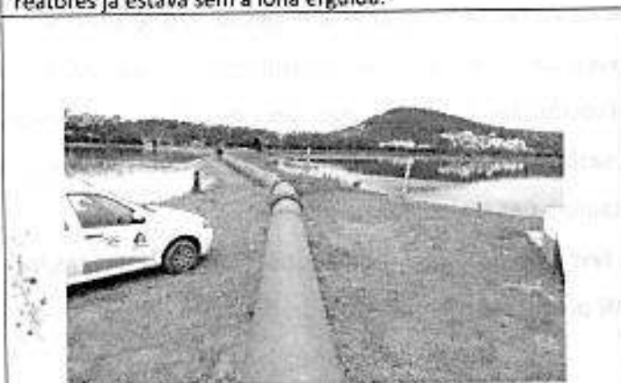
FOTO 02 – Tubulação de distribuição do efluente bruto nas lagoas.
