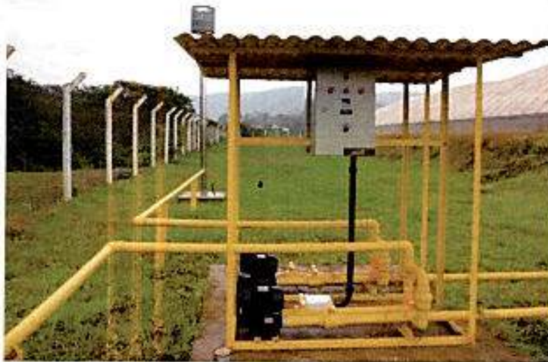
Painel de Controle dos Queimadores. Fonte: Acervo CASAN
