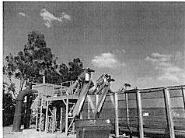
Figura 5. Tratamento preliminar por gradeamento.
