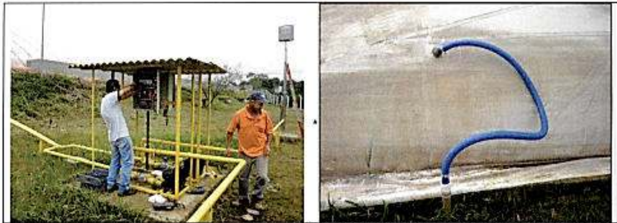
Imagem 6 e 7 - Energização e programação do quadro de controle e controle e conexão da Rede de Gás aos Reatores. Fonte: Acervo CASAN
