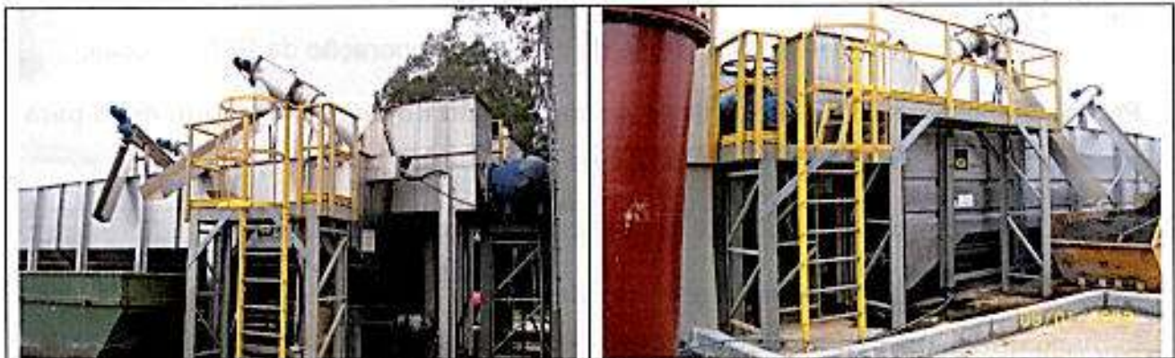
Figura 5 – Acessibilidade ao Pré-tratamento - ETE POTECAS. Fonte: Acervo Casan
